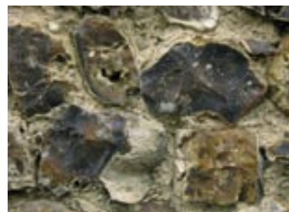
Moellons de silex aux arêtes vives et aux nuances colorées brillantes liés par un mortier.
